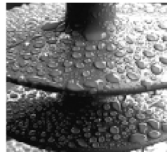
Gb.14.7. Permukaan isolator dan butir-butir air.
